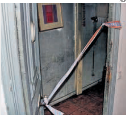
Estat en què va quedar la casa de la dona després de l'incendi.
