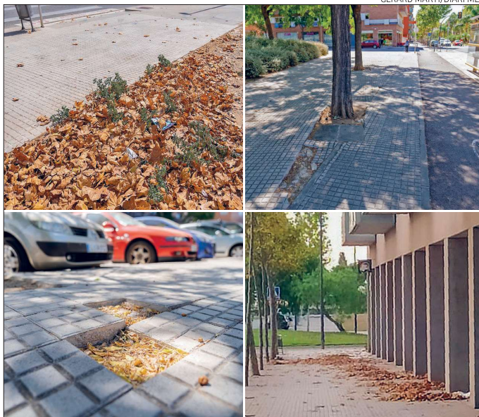
Imatges dels desperfectes a les voreres i la falta de neteja al barri de Mas Iglesias.
